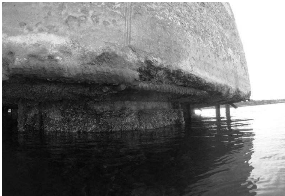
Рис. 2. Руйнування бетону і оголення арматури
