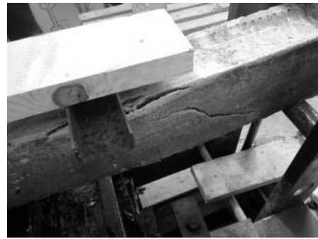
Рис. 6. Похила смуга тріщин у дослідному зразку
