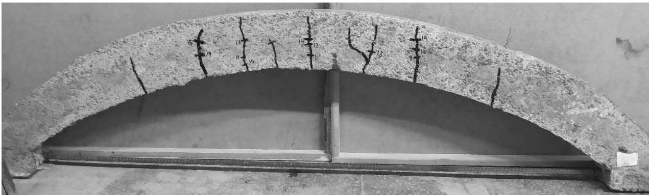
Рис. 9. Характер тріщиноутворення у поясі арки А-1(2)
