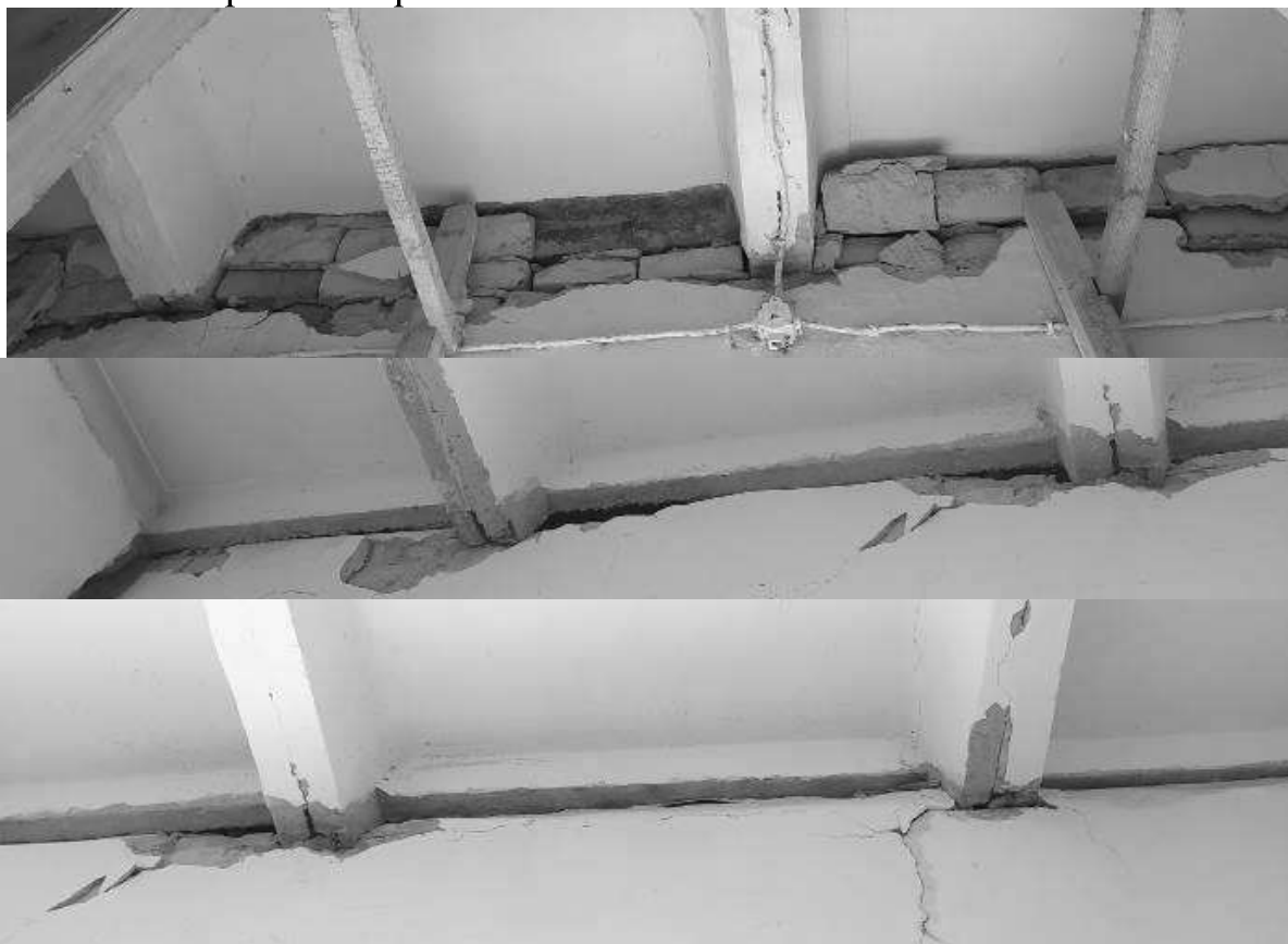
Рис. 3. Зміщення плит покриття на опори (фронтальна до епіцентру вибуху стіна)
