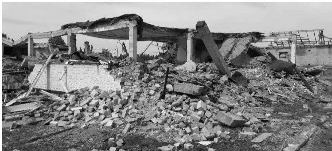
Рис. 2. Руйнування будівлі №1 в епіцентрі вибуху
