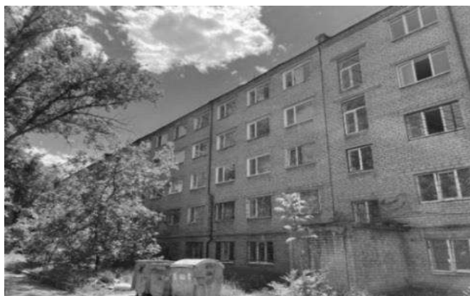
Рис.1. Існуюча будівля гуртожитку в місті Запоріжжі, що потребує термомодернізації
