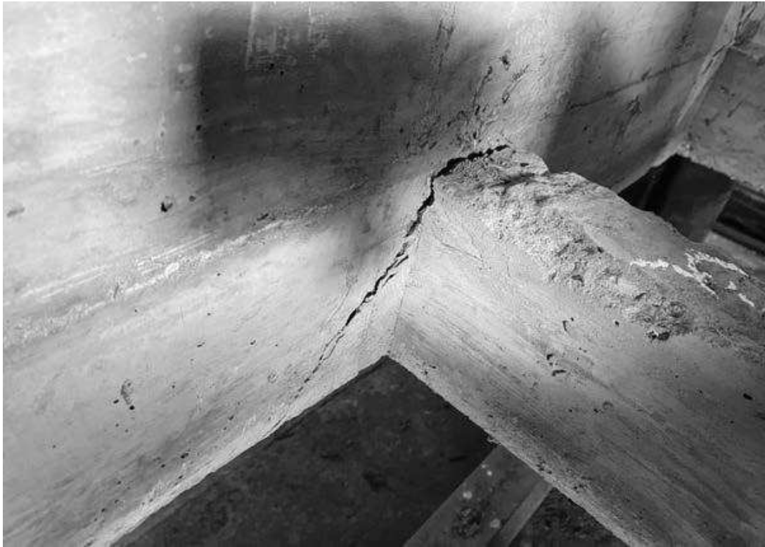
Рис. 5. Загальний вигляд тріщини відриву другорядних балок
