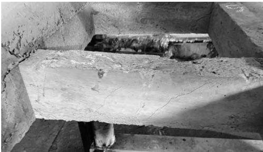
Рис. 6. Загальний вигляд спіральної тріщини в крайній другорядній балці
