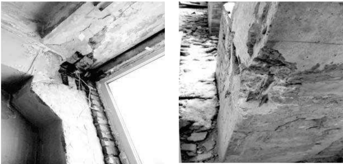
Рис.3. Натурні обстеження ушкоджених корозією конструкцій
