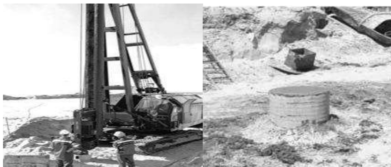
Рис. 4. Буріння свердловини для виготовлення дослідної палі та виготовлена і сформована в верхній частині незнімною опалубкою палля
