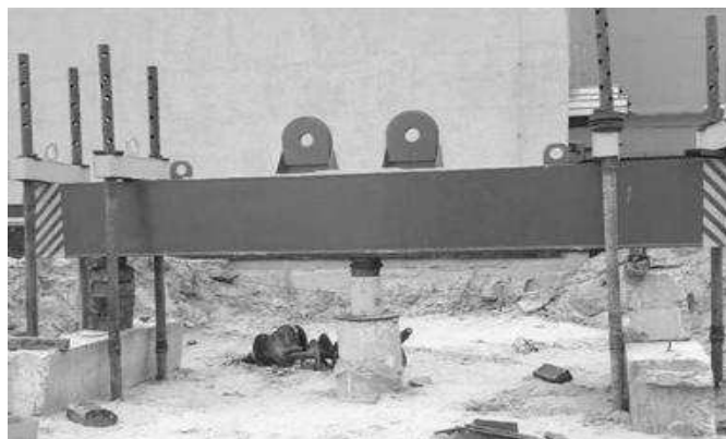
Рис. 5. Система з металевих гвинтових анкерних паль, металеві балки і гідравлічного домкрату для проведення випробувань ґрунтів дослідною палею статичними вдавлювальними навантаженнями
