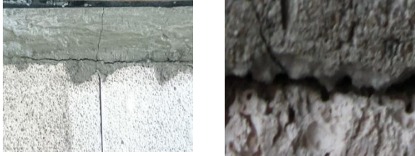
Рис.2 Утворення тріщин в контактній зоні «кладка - штукатурне покриття»
