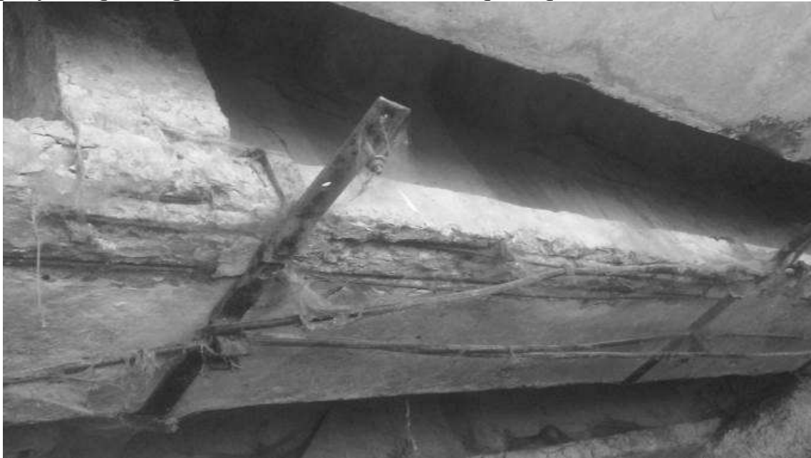
Рис. 2. Оголення та провисання струн попередньо напруженої арматури струнобетонних прогонових балок моста
