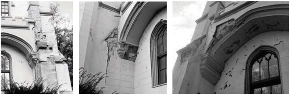
Фото 3. Пошкодження фактурного шару стіни.
