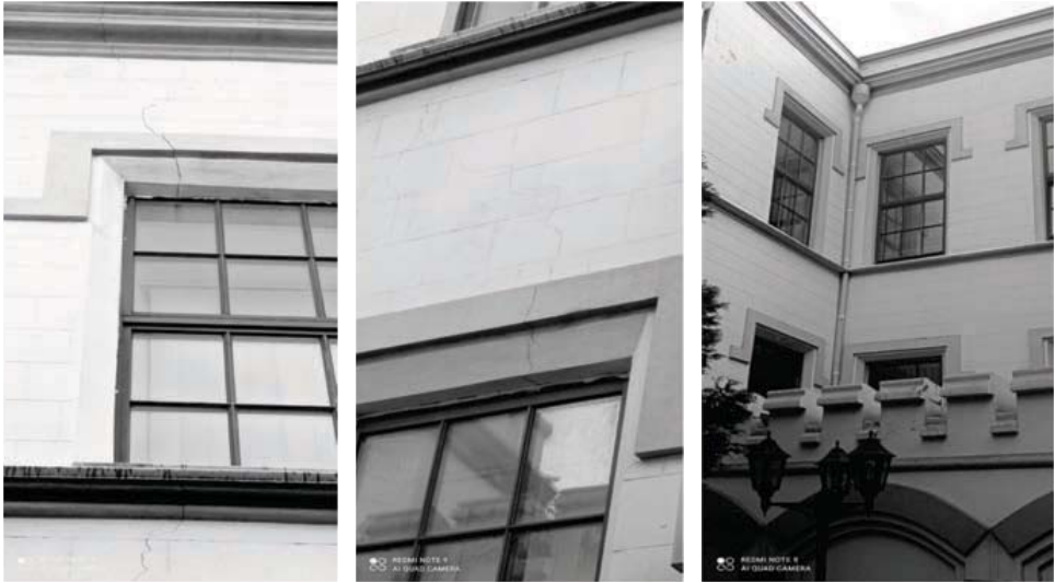
Фото 2. Тріщини у зовнішніх поперечних несучих стінах корпусу.
