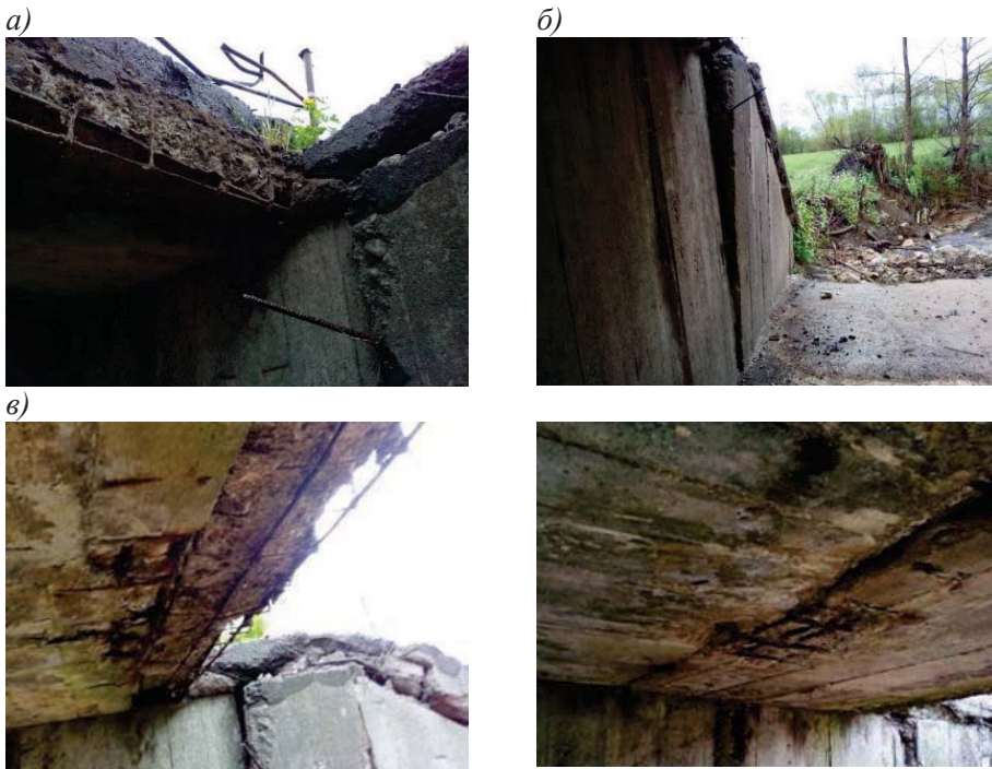
Рис. 4. Характерні дефекти залізобетонних конструкцій моста:
