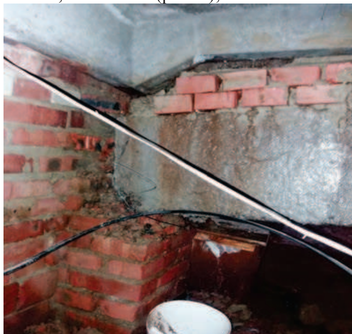
Рис. 4. Руйнування цегляної кладки пілястри
