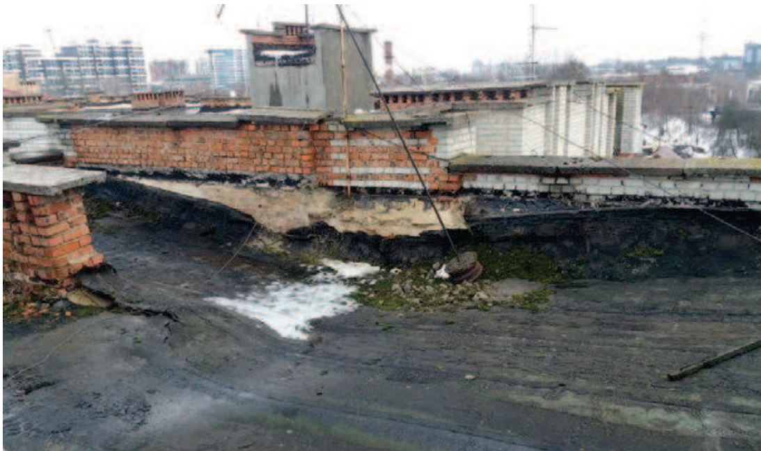
Рис. 3. Просідання покрівлі, руйнування конструкції покрівлі
