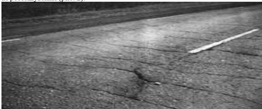
Рис. 2. Існуючі деформації та дефекти на ділянці автомобільної дороги Н-25 на ділянці км 175+950
